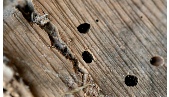
Bohrlöcher von Holzbienen
